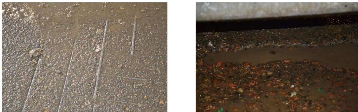
Figur 2.1 Skador på betonggolvet i lagringshallen samt under transportband
